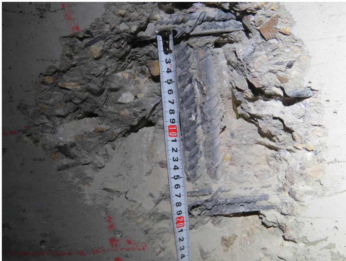
Рис. 3.2.8. Определение шага горизонтального армирования пилона в участке вскрытия 6 в осях 25/А-Б в уровне подвального этажа
