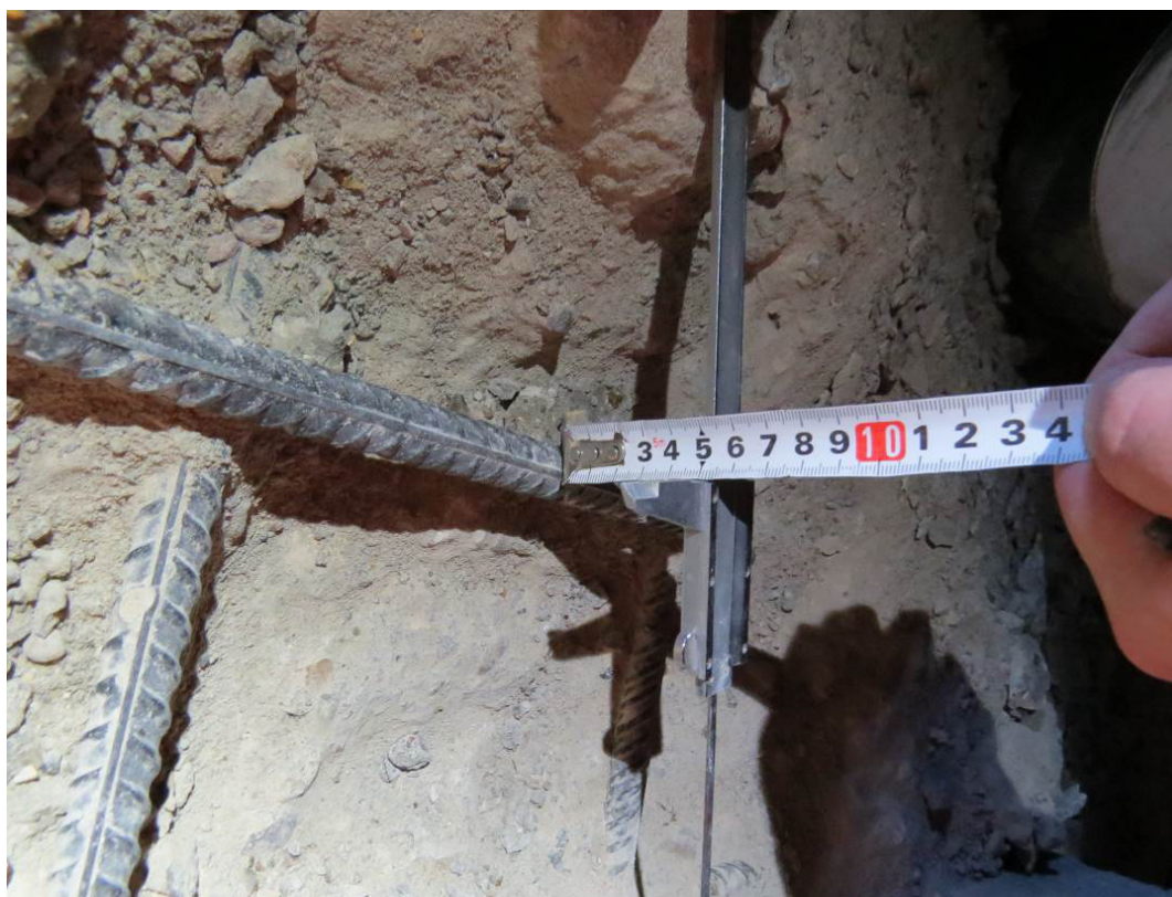
Рис. 3.1.8. Определение толщины защитного слоя бетона верхней зоны армирования фундаментной плиты на участке вскрытия в секции 3 между осями 23-24, А-Б
