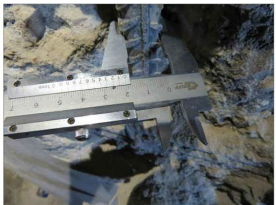
ФОТО 16. Уточнение диаметра арматуры монолитного железобетонного пилона на отм. ниже ±0.000 на пересечении осей Б/25
