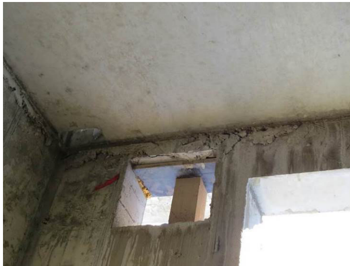
Рис. 3.2.10. Нарушение технологии возведения, а именно непровибрированность на отм. ниже \pm 0.000 по оси Д/А-Б
