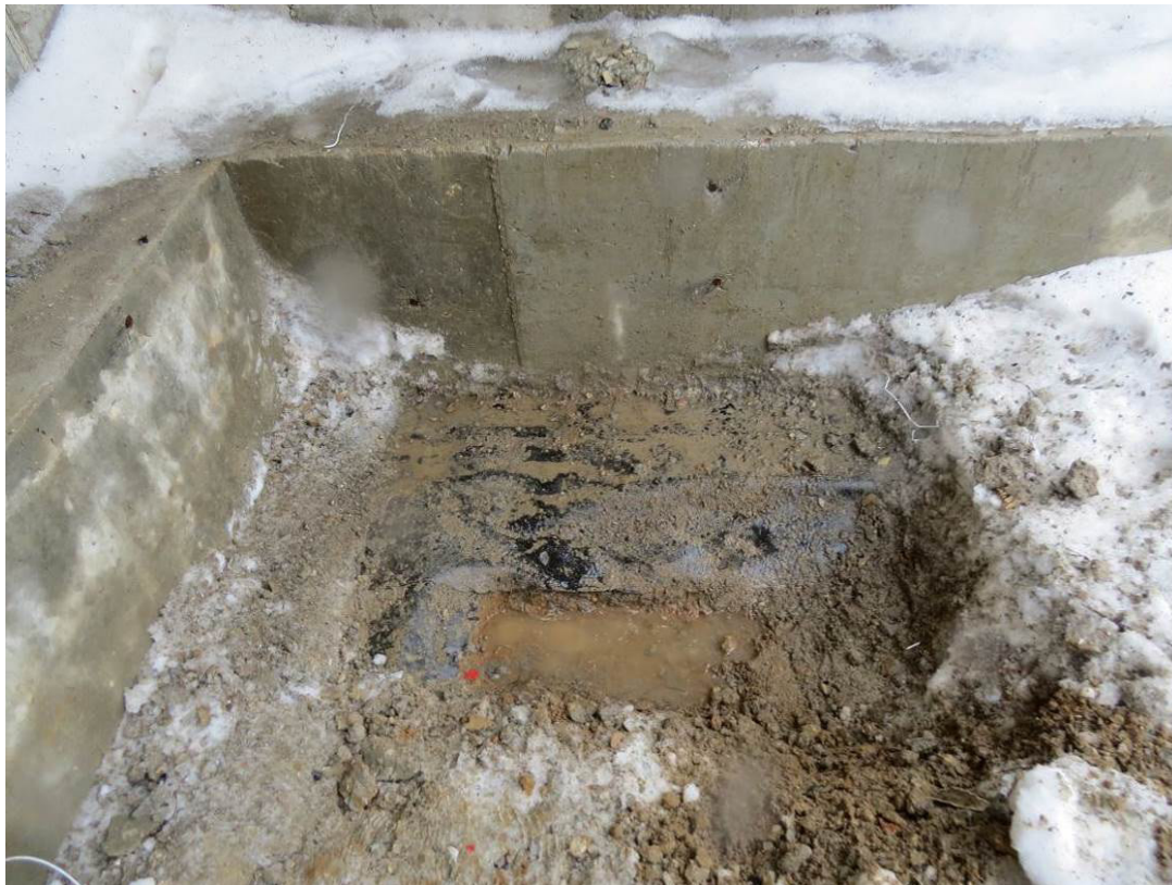
Рис. 3.1.1. Шурф №1 под наружную несущую монолитную ж.б. стену снаружи здания секция 3 между осями 24-26 по оси Г
