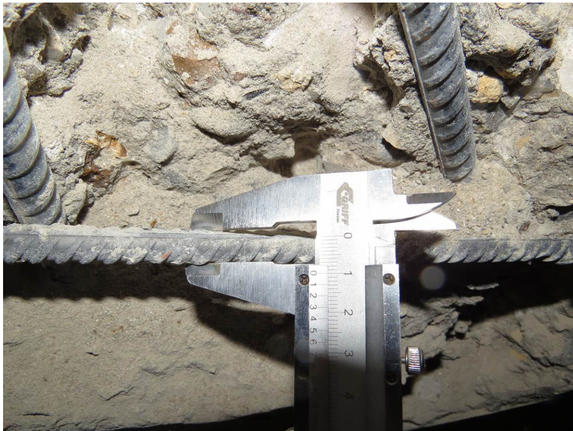
Рис. 3.2.6. Определение диаметра горизонтального армирования стены выше отм. \pm 0.000 на участке вскрытия 3 в осях 24/Б-В
