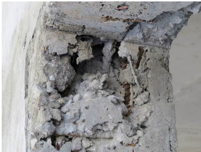
Рис. 3.2.11. Нарушение технологии возведения, а именно непровибрированность участка наружной стены в зоне дверного проема по оси 28/А-Б
