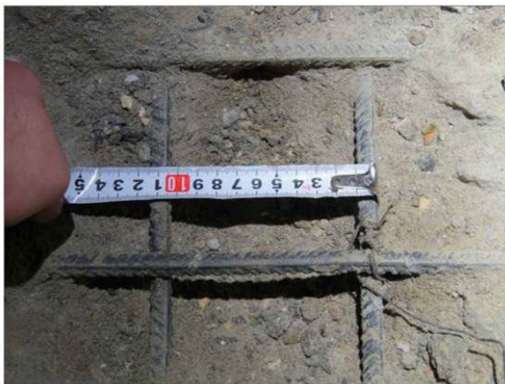
ФОТО 7. Общий вид вскрытия монолитной железобетонной плиты перекрытия на отм. -0.100 в осях А-Б/25-26
