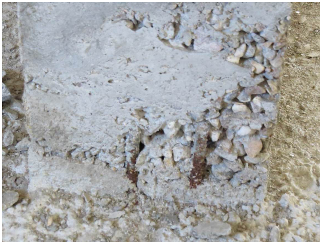
Рис. 3.2.9. Отсутствие защитного слоя бетона с оголением армирования и поражение коррозией на отм. ниже \pm 0.000 м в пилоне по оси К/1-3
