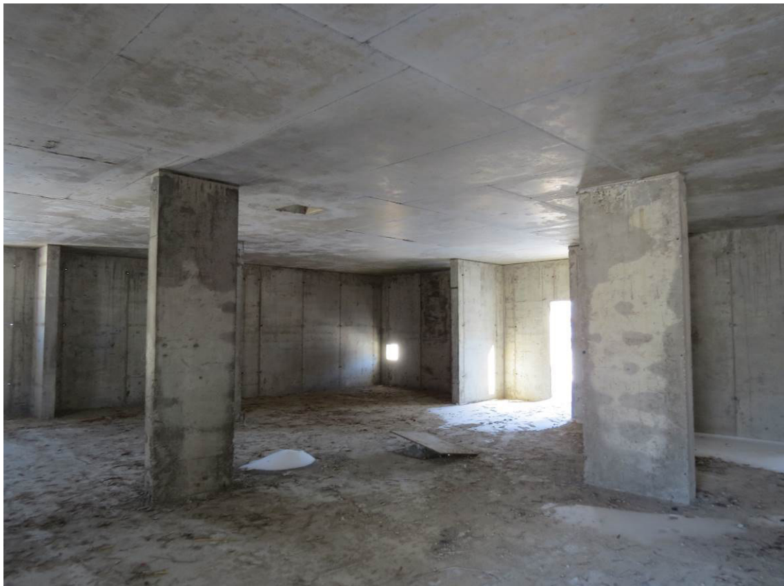
Рис. 3.3.1. Общий вид конструкций ж.б. плиты перекрытия в зоне подвального этажа в осях К-Н/2-6
