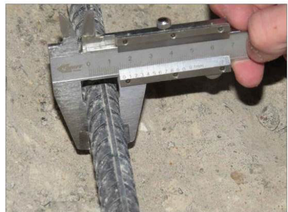
ФОТО 12. Уточнение диаметра арматуры монолитной железобетонной фундаментной плиты на отм. -3.400 в осях А-Б/23-24
