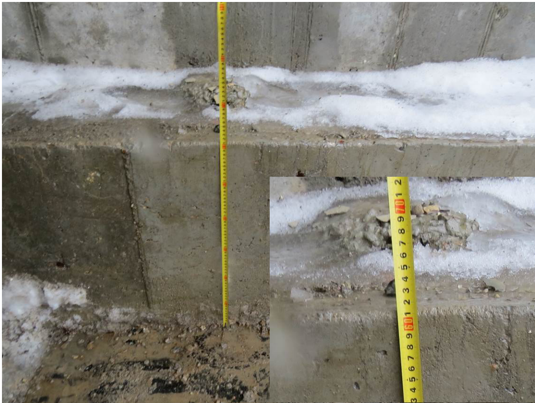
Рис. 3.1.3. Замер толщины фундаментной плиты в отрытом шурфе №1 секция 3 между осями 24-26 по оси Г
