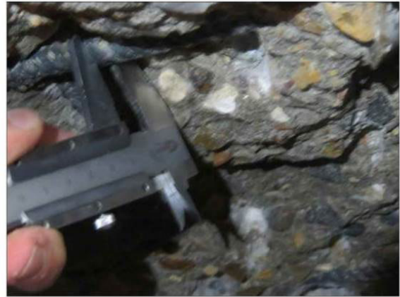
ФОТО 14. Уточнение диаметра арматуры монолитной железобетонной плиты перекрытия подвала на отм. ниже ±0.000 между осями А-Б/23-24
