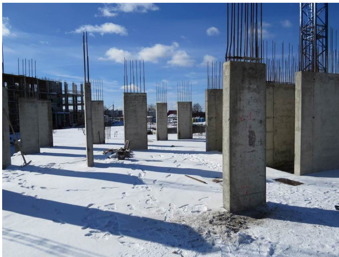
Рис. 1.6. Общий вид смонтированных вертикальных конструкций первого этажа в осях 25-20 и А-В жилого дома №23
