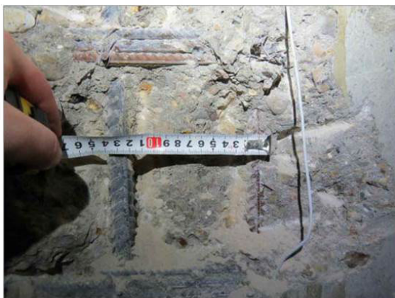
ФОТО 15. Общий вид вскрытия арматуры монолитного железобетонного пилона на отм. ниже ±0.000 на пересечении осей Б/25
