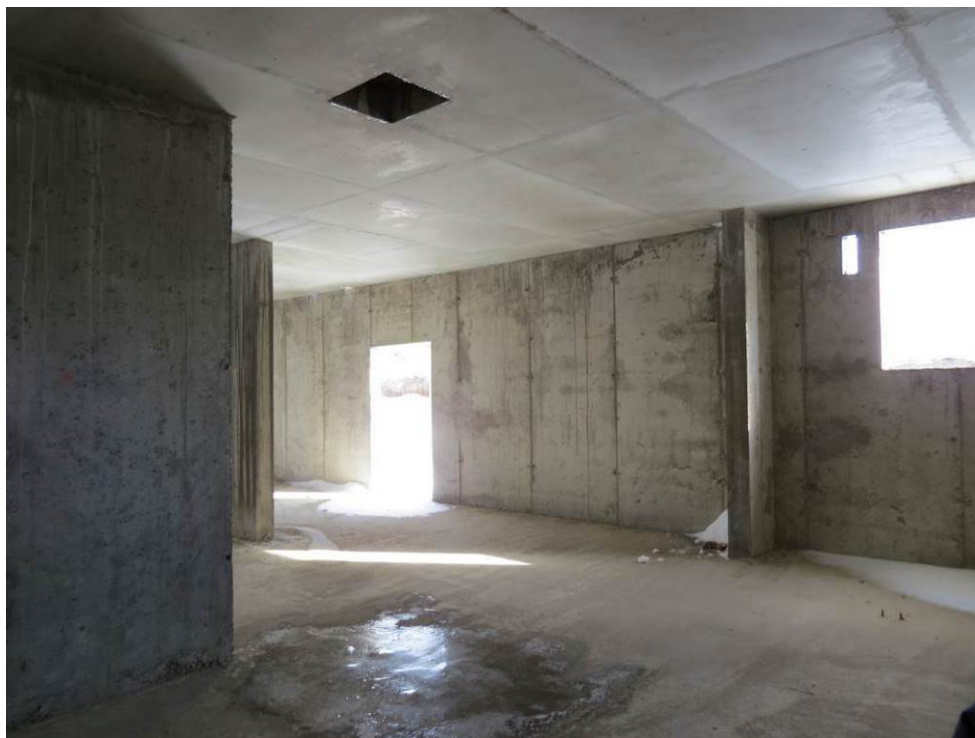
Рис. 3.1.10. Проникновение воды в подвальное помещение в местах прохода коммуникаций и проемов наружных стен
