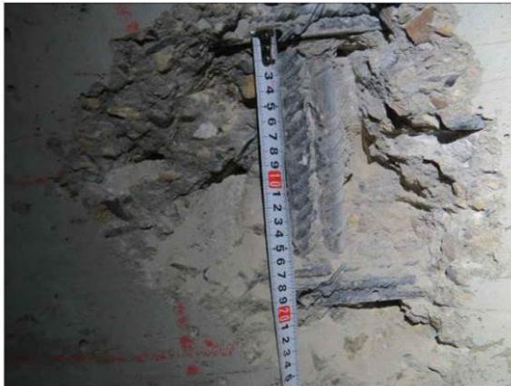
ФОТО 6. Общий вид вскрытия монолитного железобетонного пилона на отм. выше ±0.000 на пересечении осей Б/25
