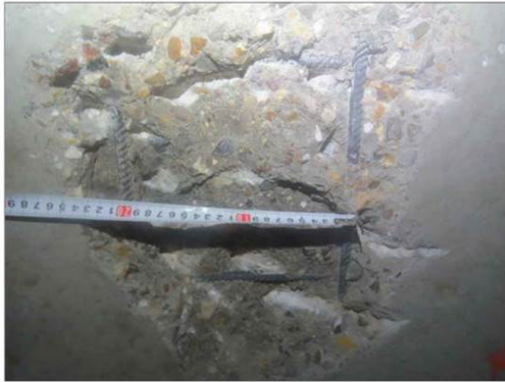
ФОТО 13. Общий вид вскрытия арматуры нижней зоны монолитной железобетонной плиты перекрытия подвала на отм. ниже ±0.000 между осями А-Б/23-24
