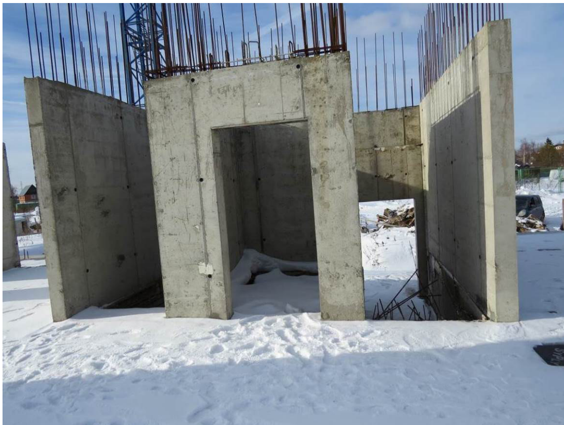
Рис. 1.5. Общий вид смонтированных конструкций лестнично-лифтового узла в уровне первого этажа в осях 23-25 и Г-Б жилого дома №23
